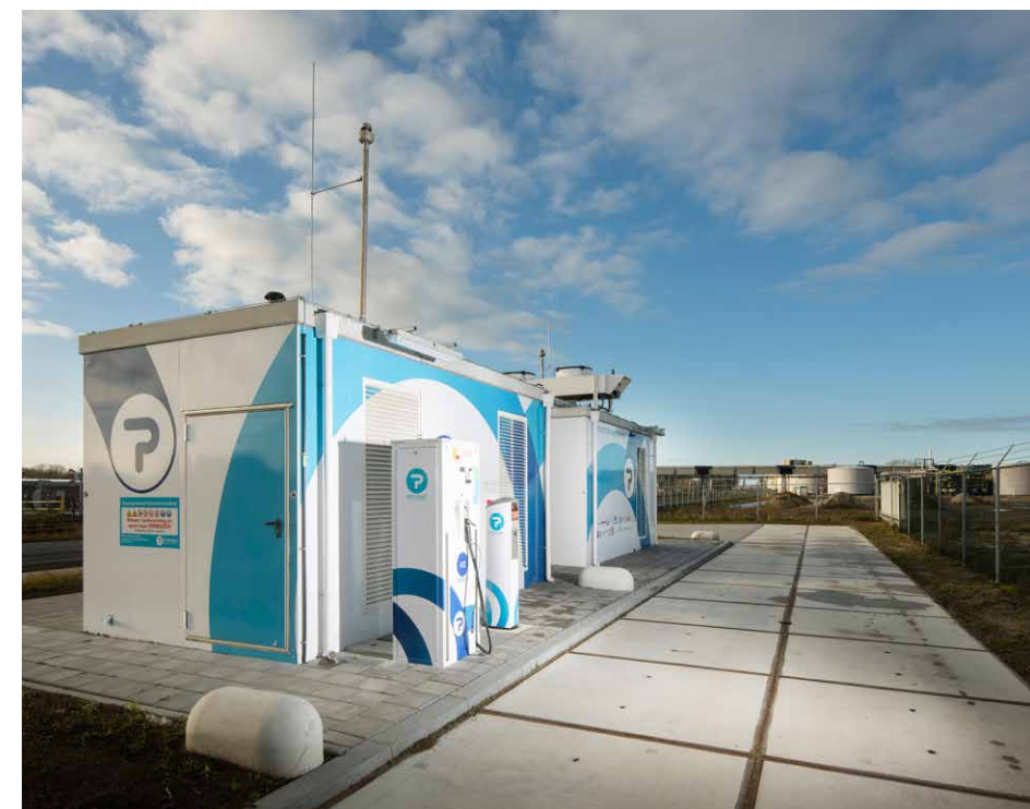
Aan de rand van het Chemie Park Delfzijl staat dit tankstation voor groene waterstof van PitPoint.
