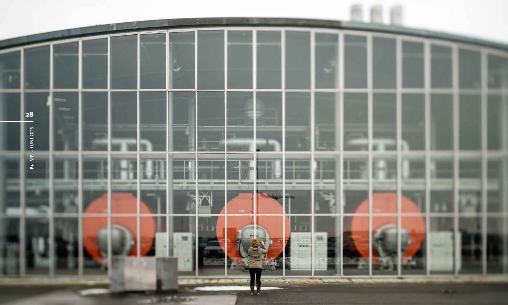
➤ Een UFO-achtig energiestation bij de luchthaven van Kopenhagen pompt warm water voor de stadsverwarming door 54 kilometer pijpleiding. "Niet minder dan 60 procent van alle 5,6 miljoen Denen maakt gebruik van de warmte uit decentrale energiecentrales."
